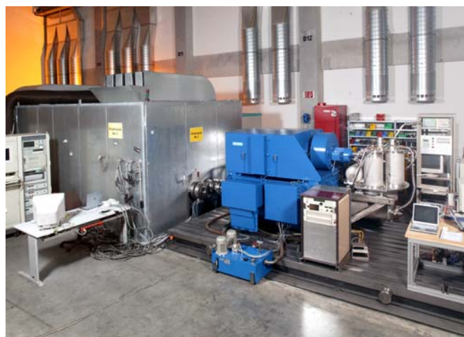
Рис. 4. ВТСП генератор на 4 МВт, Siemens+EAS, 2005 г.
