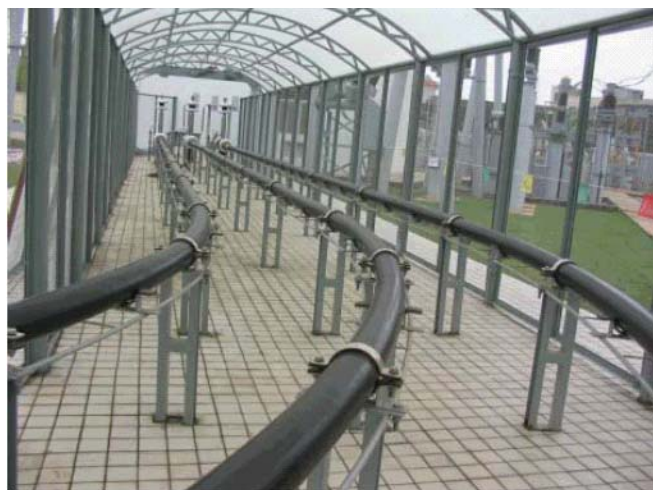
Установленный в Китае BSCCO сверхпроводящий кабель
